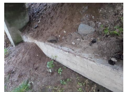
4.6. pav. Nutrupėjęs kolonas jungiančios sijos betonas, koroduoja armatūra
