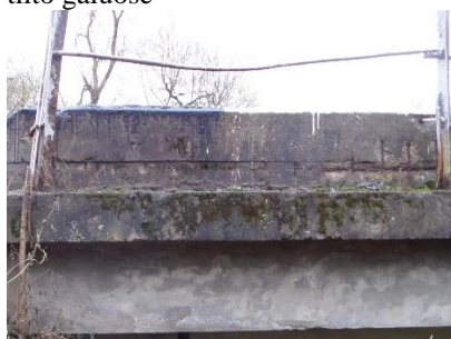
4.4. pav. Vandens ir druskų korozijos paveikti turėklų ir atitvarų blokai
