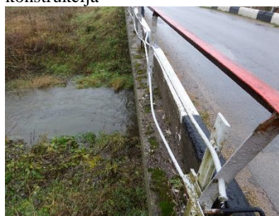
4.5. pav. Turėklai sulankstyti, statramsčių įbetonuoti galai stipriai sukorodavę
