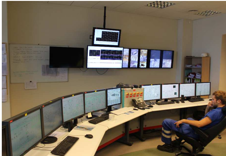
2.13 pav. Klaipėdos termofikacinės jėgainės valdymo pulto bendras vaizdas
