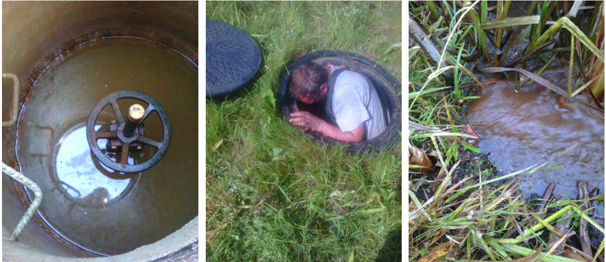
2.2.9.1 pav. Vandens nuleidimo šulinys su sklende ir ištekėjimo žiotys prasidėjus tėkmei iš šlapynės
