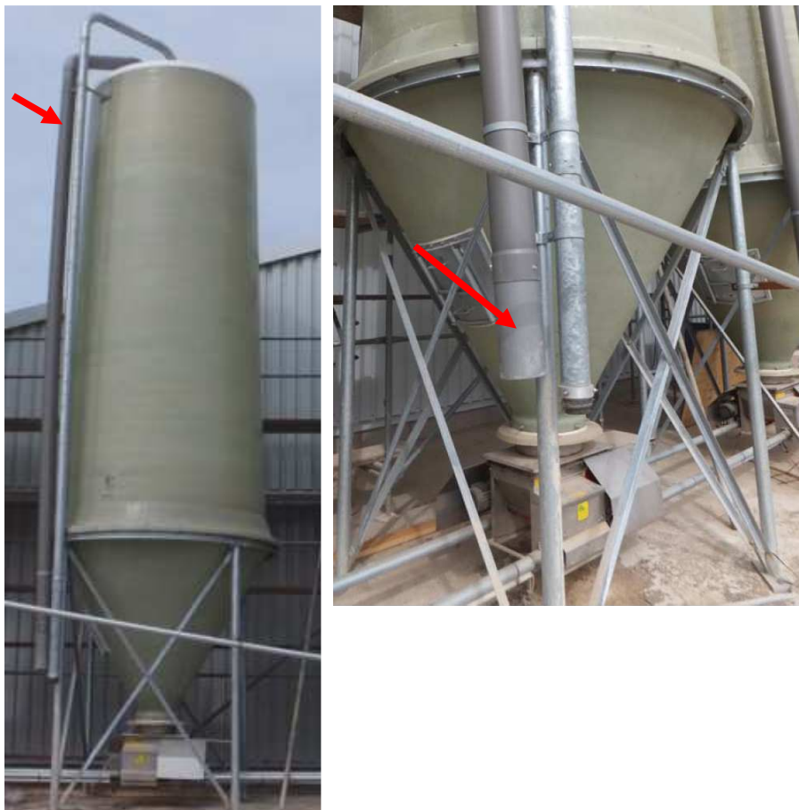
3 pav. Plastikinis pašarų bunkeris. Vamzdis, skirtas perteklinio oro nuvedimui
