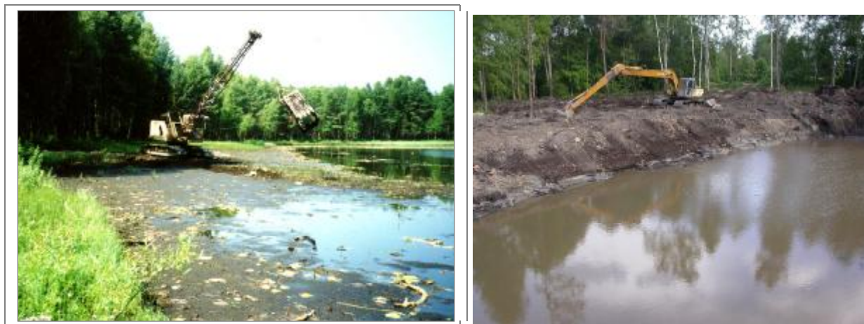
4.12 pav. Ežero pakrančių valymas ekskavatoriumi draglainu E-304 ant klojinių bei ilgagrėliu ekskavatoriumi Case (A.Ciūnio nuotr.)
