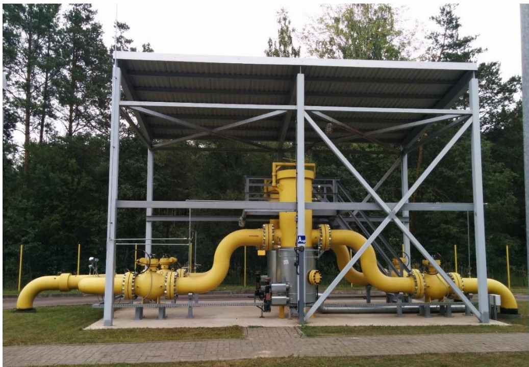
2 pav. Dujų valymo filtrų aikštelės su stogine pavyzdys
