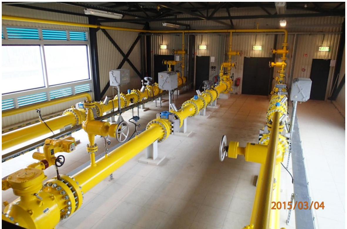
3 pav. Dujų apskaitos ir slėgio ribojimo linijos DASRS pastate pavyzdys
